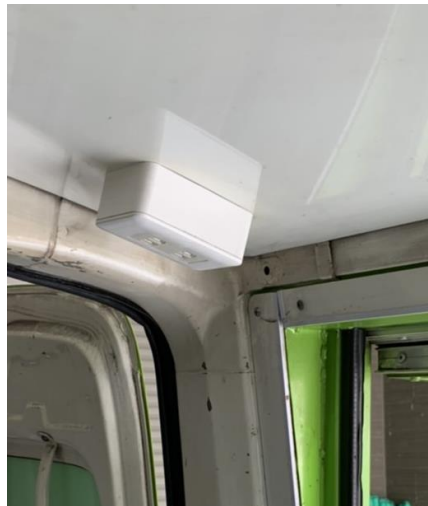
電源（助手席側後方天井）
