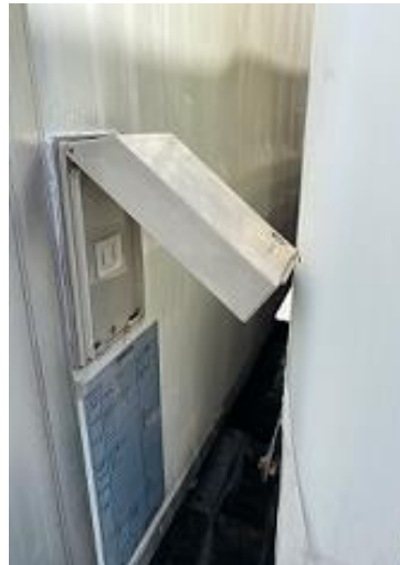
外部電源差込口 (運転席裏)
